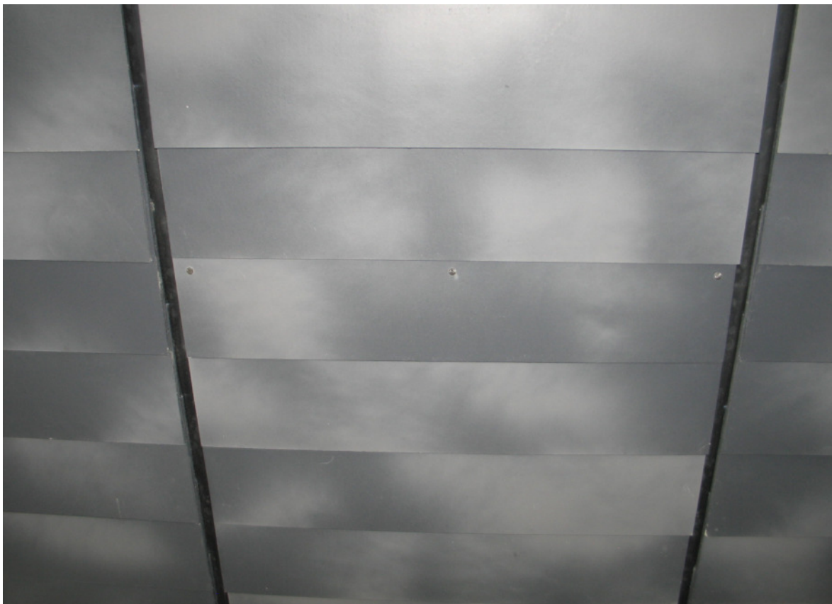
Changement des 2 ardoises détériorées. Une peinture de retouche est à prévoir pour masquer les clous apparents.
