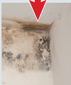
Développement de moisissures.
