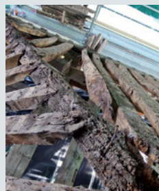
Dégradation de la charpente.
