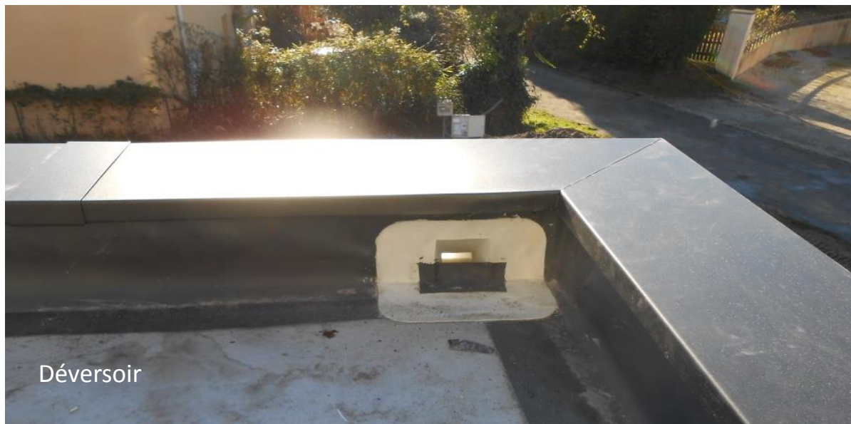
Figure 36 - Traitement des eaux pluviales
