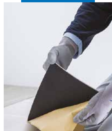
pose de LVT à envers adhésif sur ancien carrelage ragréé avec Planiprep 4 LVT
